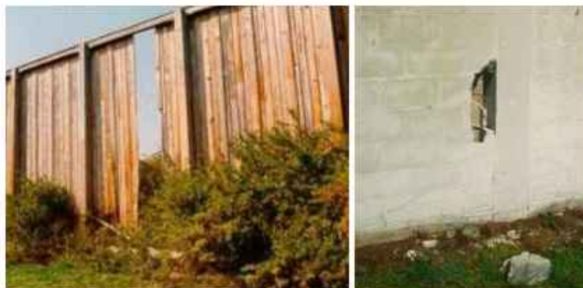
Слика 5.4. Примери оштећења на баријерама [25]
