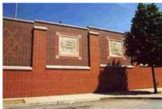
Слика 3.85. Панелни умети причвршћени на бетонску баријеру [25]
